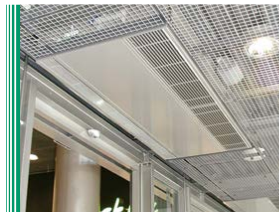
VENTILACIÓN ROOF TOP
